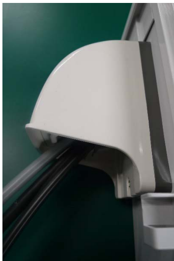
引き込みカバー部
